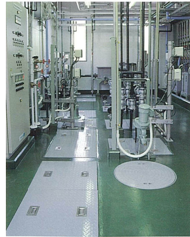
写真 4 処理施設内部
