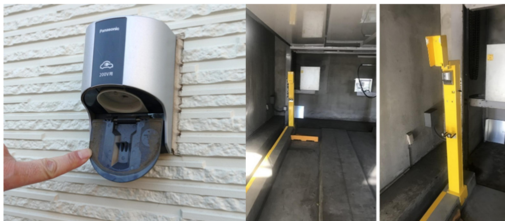
【図表63】（左）住宅の駐車場に設置したEV充電用200Vコンセント、（中・右）集合住宅の機械式駐車場に設置されたEV用200Vコンセント（写真提供：ユアスタンド）
