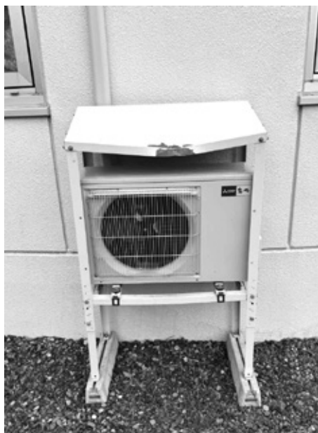
変形した室外機ラック (近藤小学校)
