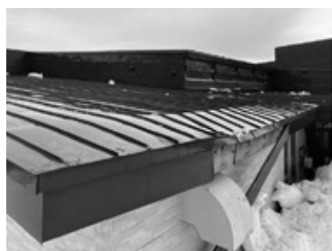
元町コミュニティセンターの 損壊状況
