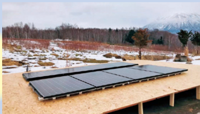
積雪強度の実験用ソーラーパネルを設置しました
