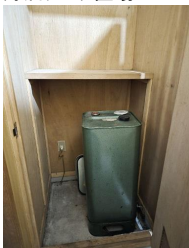
灯油タンク置場
