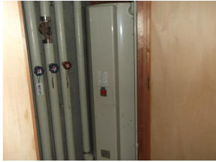
電気温水タンク
