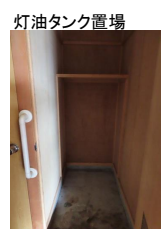
灯油タンク置場
