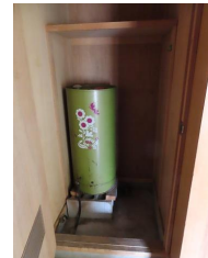
灯油タンク置場
