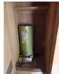
灯油タンク置場
