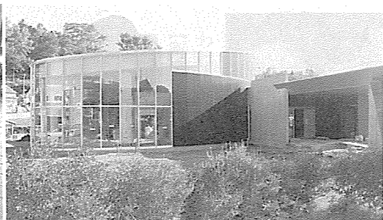
▲完成が待ち遠しい来春オープン予定の中央地区温泉施設
