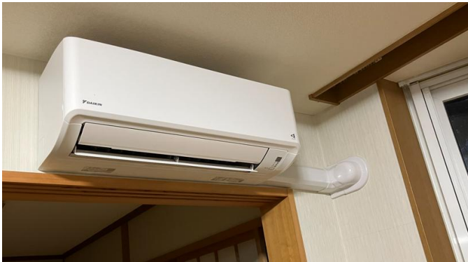
写真：補助制度によって新設された高効率空調機（エアコン）
