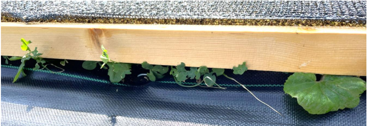
写真：栈木が浮いた状態、隙間から日光が入り雑草が成長する
