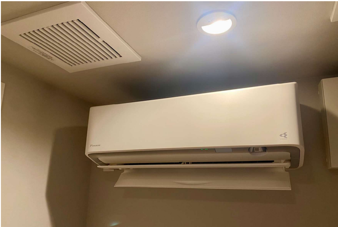
写真：玄関に設置されたエアコン。この1台で80㎡の住戸全体を一定の温度に保つ
