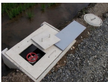
給水設備が整っており 7 時間で水張可能
