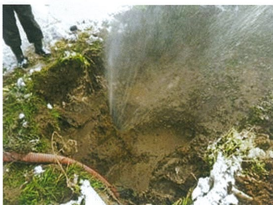
図-2 漏水の様子
