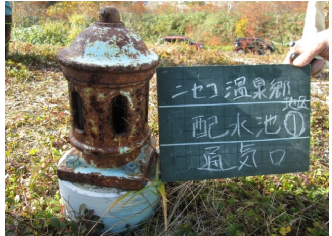
屋外の配水池通気口
