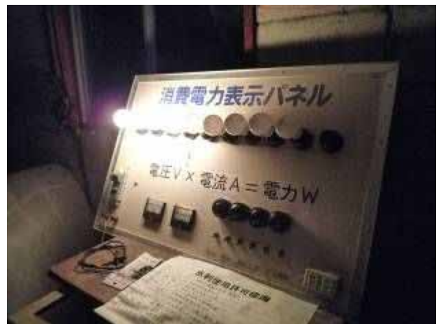
手作り配電設備と電力モニタ(電気設備の熟練工が協力)
