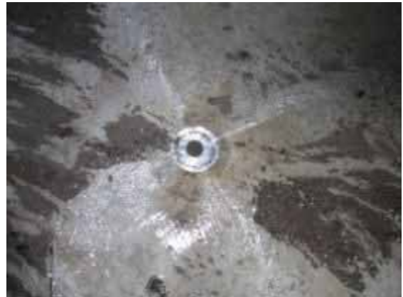
道路用散水ヘッドで水を流す
