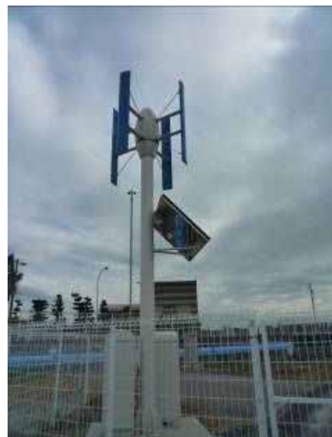
蓄電式小型風力発電装置
