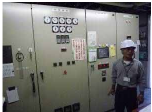
変電システム
