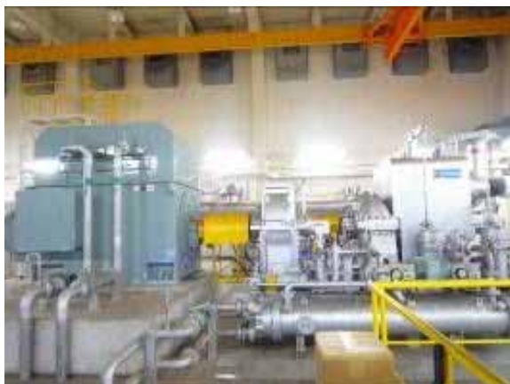
蒸気タービン
