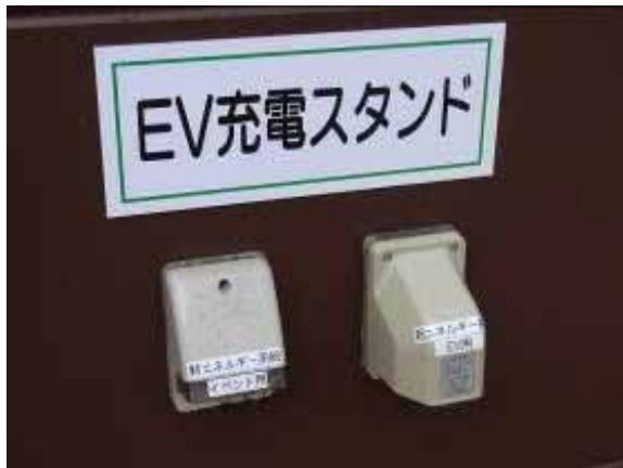
電気自動車用充電設備
