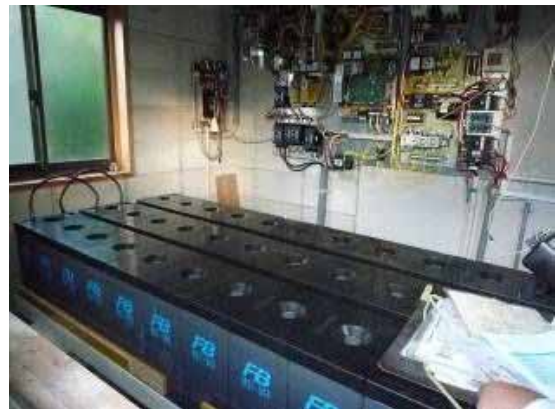
設置者の自作による変電・充電設備
