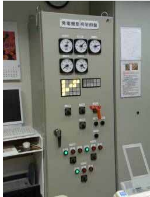
発電機監視制御盤
