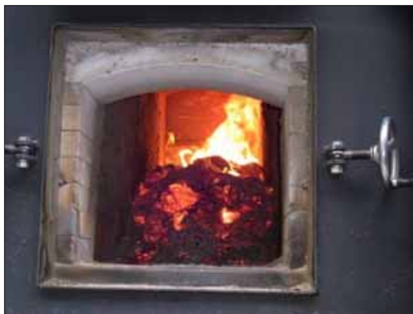
ボイラー燃焼炉
