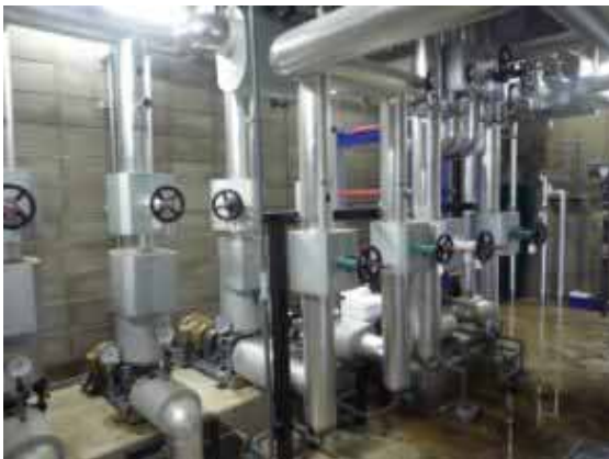
熱交換冷水循環方式を採用している
