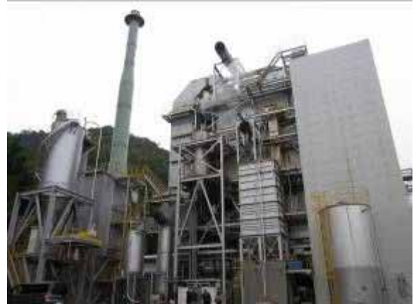
流動層ボイラー全景
