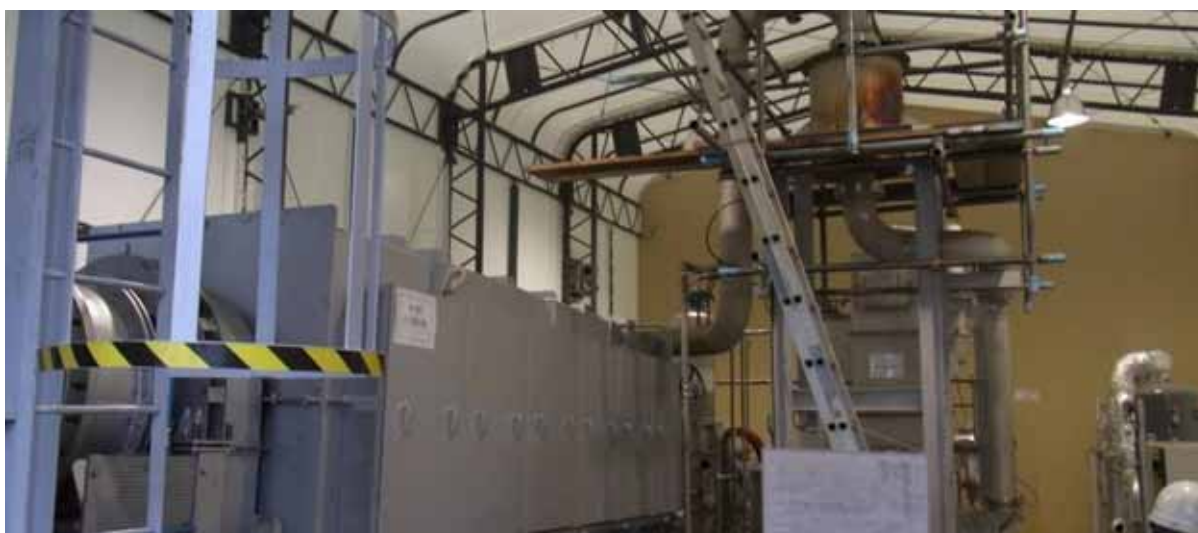
プラント内部
