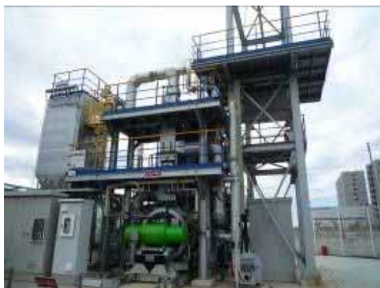
バイオマス利用スターリングエンジン発電
