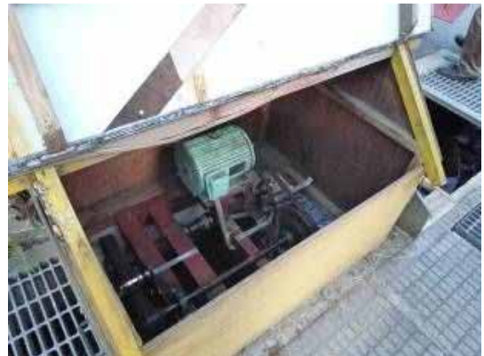
川上ミニ水力発電(モーター部分)
