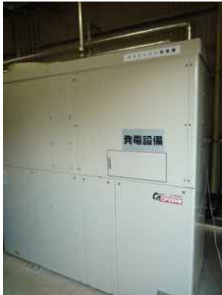
ガスエンジン発電機
