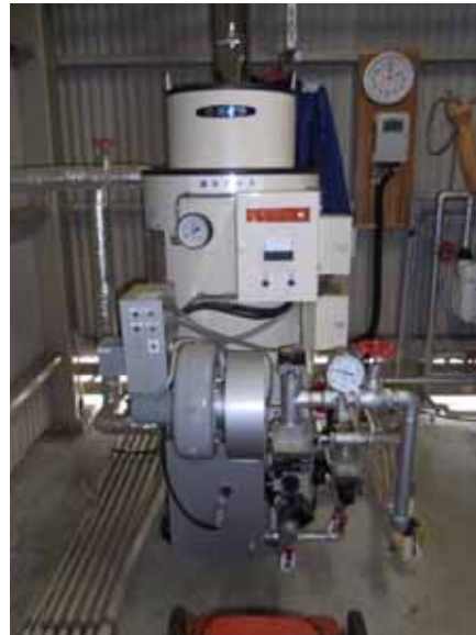
温水ボイラー
