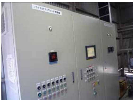
バイオガスプラント制御盤
