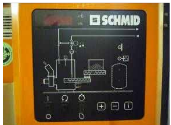
チップボイラー
