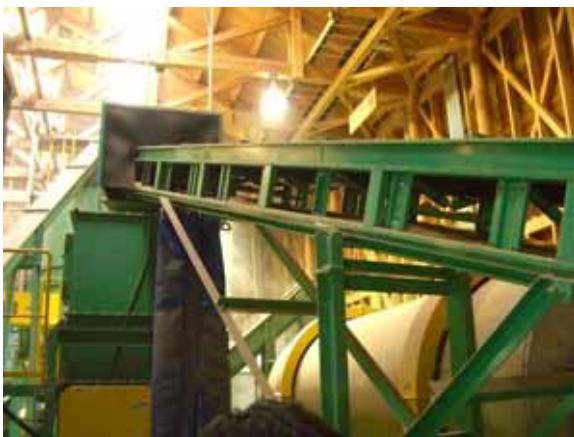
熱風発生炉に入れた後、乾燥機に入れ乾かす
