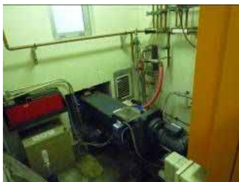
燃料庫からボイラーへチップを供給する装置
