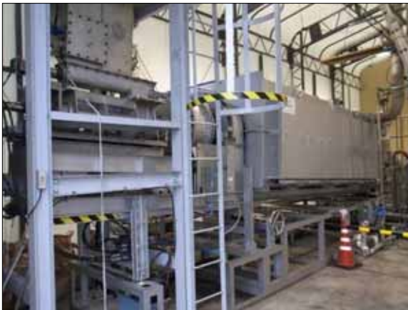
原料をガス化するガス発生器
