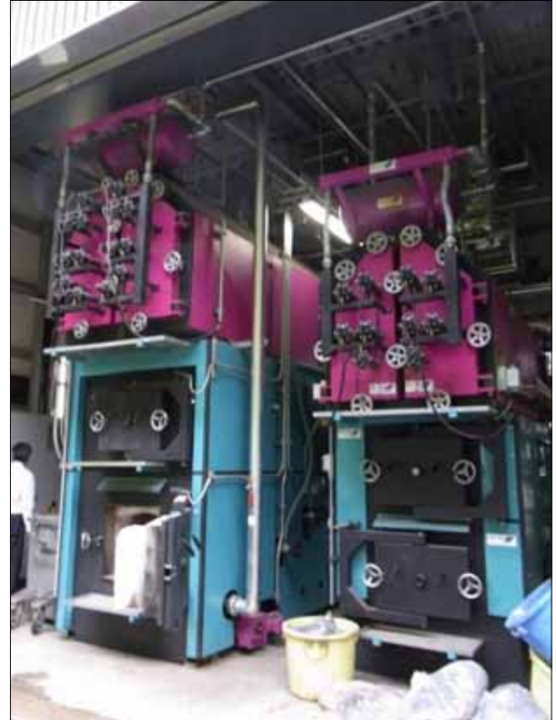
右が250kWのボイラー、左が常時稼働している500kWのボイラー
