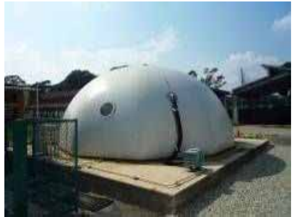
ガスホルダでは空気が入らないように保ちバイオガスを収集する
