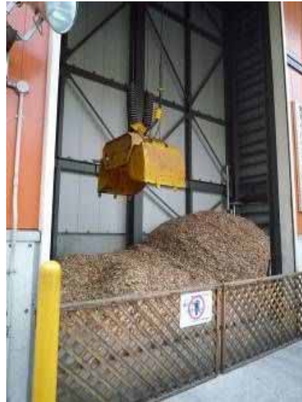
自動的にクレーンがチップを乾燥炉へ投入
