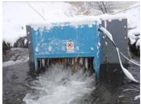
筐体の外側は水しぶきにより凍結しているが水車の羽根は凍結することなく回転している(12/11)
