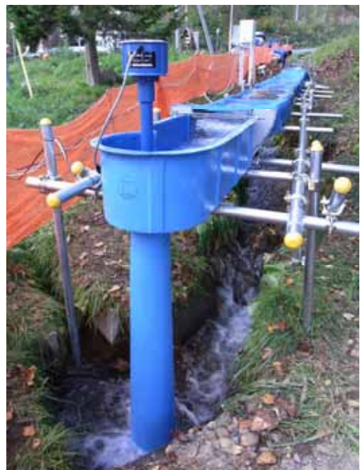
縦型式水力発電機の全景
