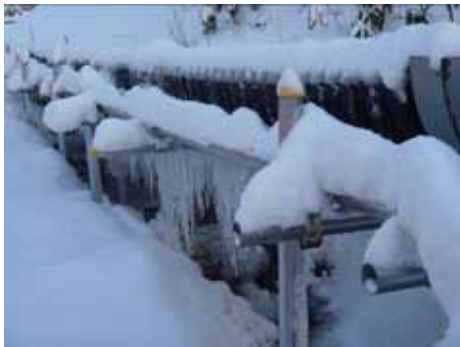
導水路も凍結しつららができている (12/12)
