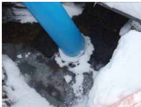
集水桝内部の水面も凍結する寒さとなっている (12/12)
