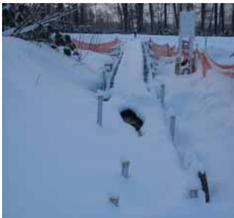
雪に覆われ凍結した導水路 (12/12)
