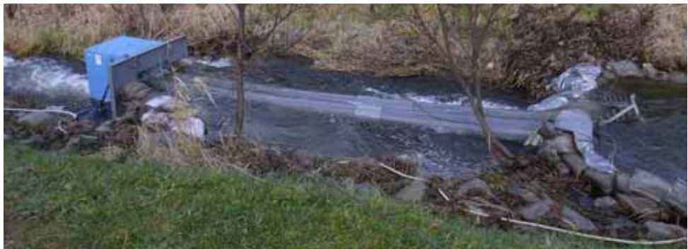
増水した水車の全景 (11/23)
