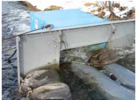
増水により位置がずれた導水管の様子(12/8)
