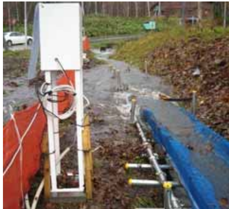
水路の氾濫の様子 (11/10)
