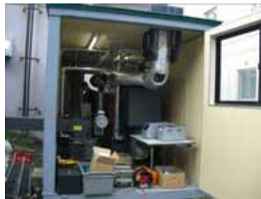
仮設ボイラー室内の様子 (東側)
