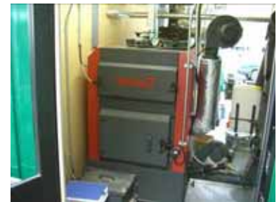
仮設ボイラー室内の様子 (西側)
