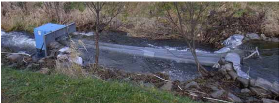
導水管と第二の堰の設置完了後の水力発電機の全景
