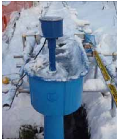
気温の低下により用水が凍結
